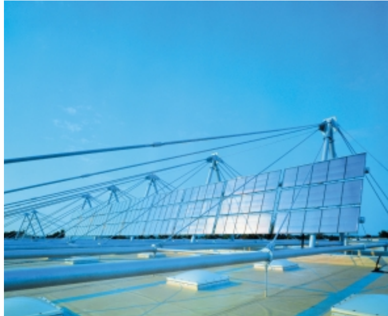
Foto 5: Anordnung der Photovoltaik-Module und der Warmwasserkollektoren zur Heizungsunterstützung.
